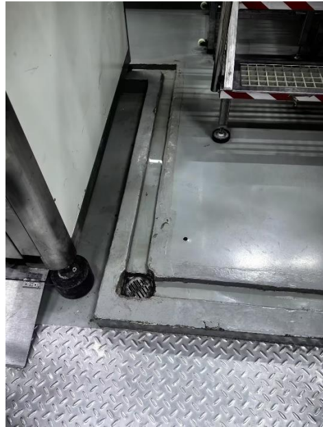
现有项目生产区导流沟、收集槽
